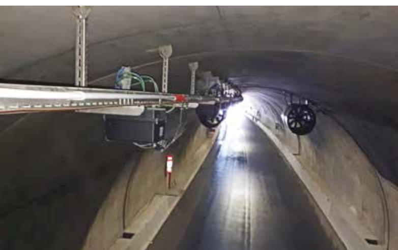
4. Impianti rilevamento incendi LIST, ventilazione e illuminazione
