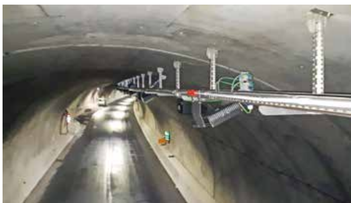
6. Il cavo sensorico SEC20 installato sul lato della canalina
